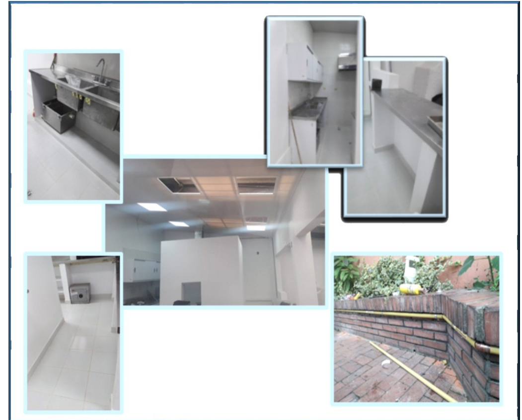
Instalaciones El Nogal: adecuaciones en área de cocina, trampas de grasas y red de gas natural.
