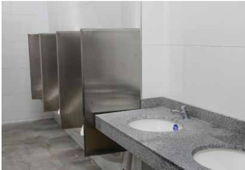
Imagen 6. Nuevas baterías sanitarias
